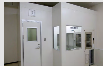
江東薬局に設置されている無菌調剤室
